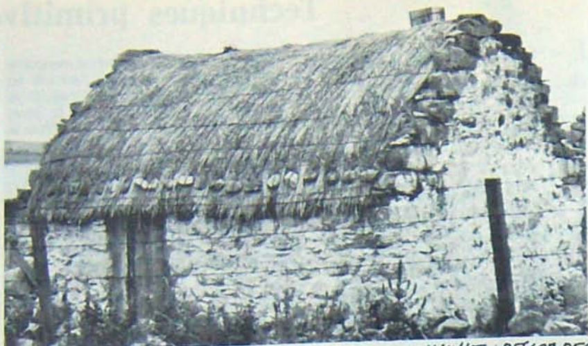
METHODE SIMPLE IRLANDAISE DE LOUVERTURE EN CHAUME. DES CORDES MAINTIENNENT LE CHAUME. LES CORDES HORIZONTALES SONT LESTÉES DE CHAQUE CÔTÉ PAR DES PIERRES.
